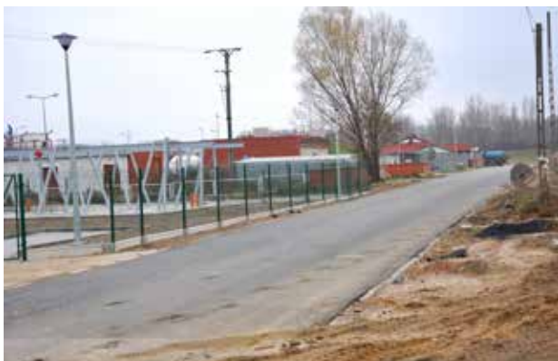
Podczyszczalnia ścieków ul. Brukowa
