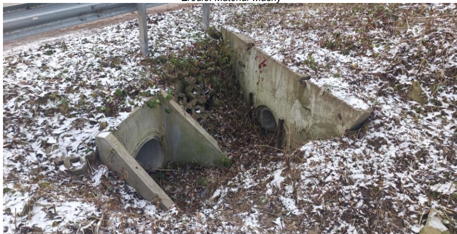
Fot.4 Przepusty na działce w północnej części terenu od strony ul. Jeziornej. Data wykonania zdjęcia: 29.11.2023r. Źródło: Materiał własny
